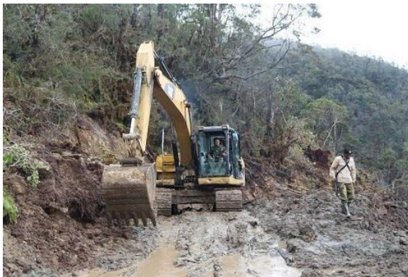
Gambar 2. Dampak Pembangunan Infrastruktur Seperti Erosi Tanah
