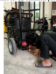
Gambar 12. Pemasangan Baterai SLA Sumber: (Dokumentasi pribadi)
