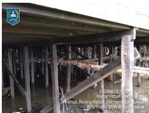
Gambar 2. Kondisi Tiang Pondasi Eksisting
